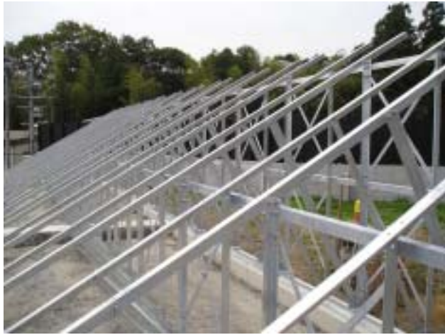
太陽光発電 モジュール 取付け架台
